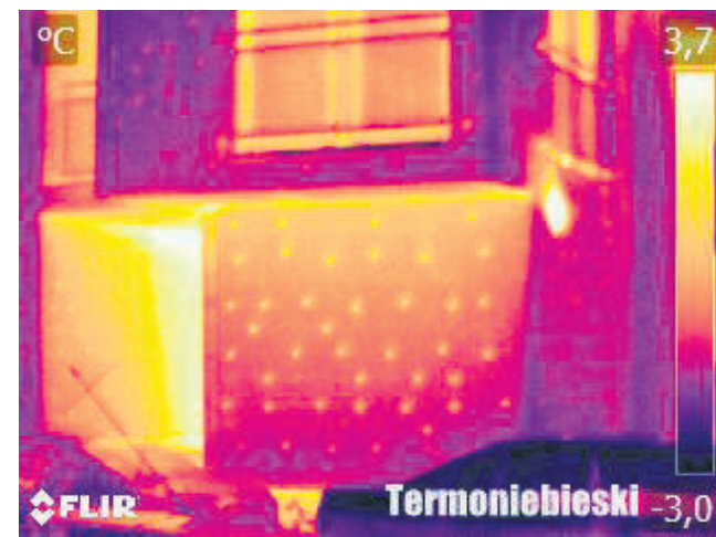
► Punktowe mostki termiczne - kolki montażowe
