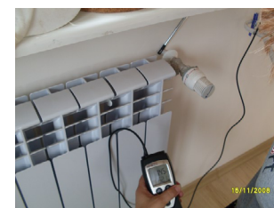
Połączenie rury od kaloryfera ze ścianą fot. Katarzyna Jaročka
