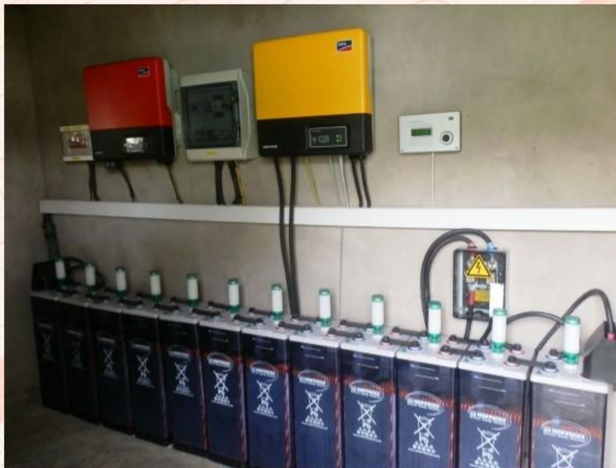
Instalacja wyspowa (off-grid).
